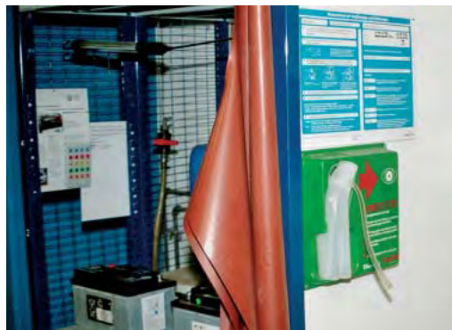
6 Stazione caricabatterie: pericolo di corrosione ed esplosione.
